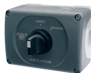
BCCA 2V 2-toeren vervuiling-ventilatie, binnen de parkeergarage.
