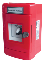
BCCP centrale regelunit voor brand start / brandweerstop / vervuilingventilatie, op referentieniveau bij iedere voertuigtoegang.
