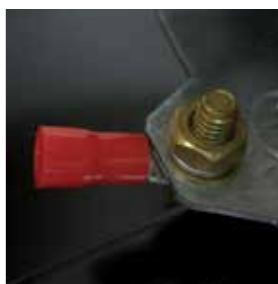
Toma de tierra
