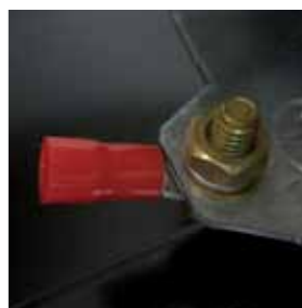
Toma de tierra
