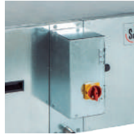
Armoire électrique intégrée Interrupteur marche-arrêt de sécurité
